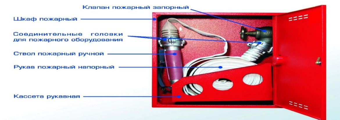
Рис. 2. Пожарный ящик с рукавом, устанавливаемый в многоэтажных домах
